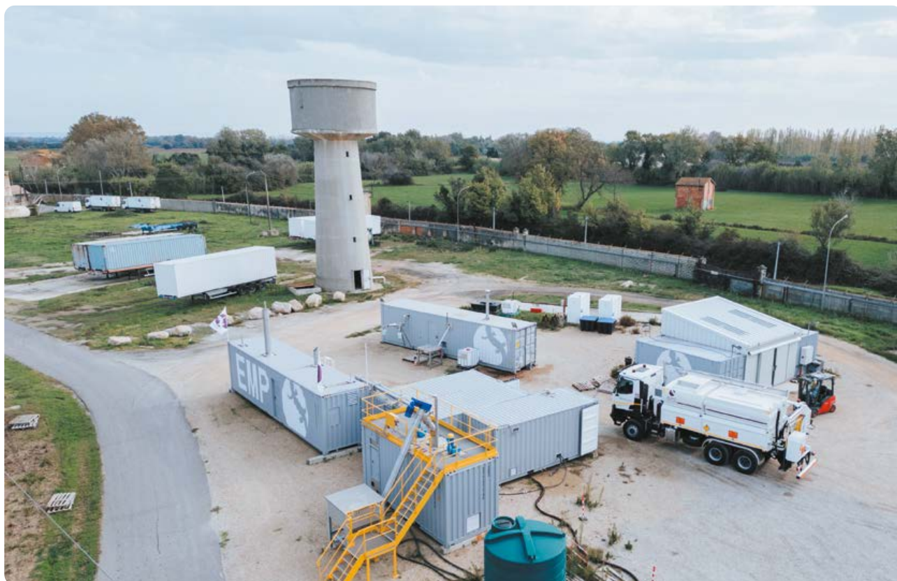
EMP (Euro Modular Plant) sur le site EPC 2i, France
