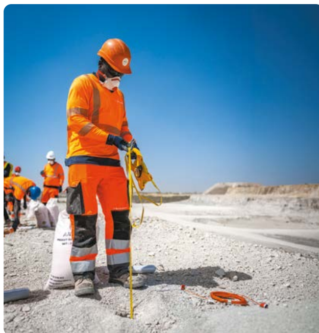
Opérateurs EPC Mineex, Sénégal
